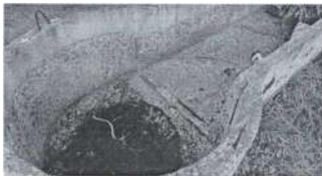
Фото незадовільного стану резервуару
