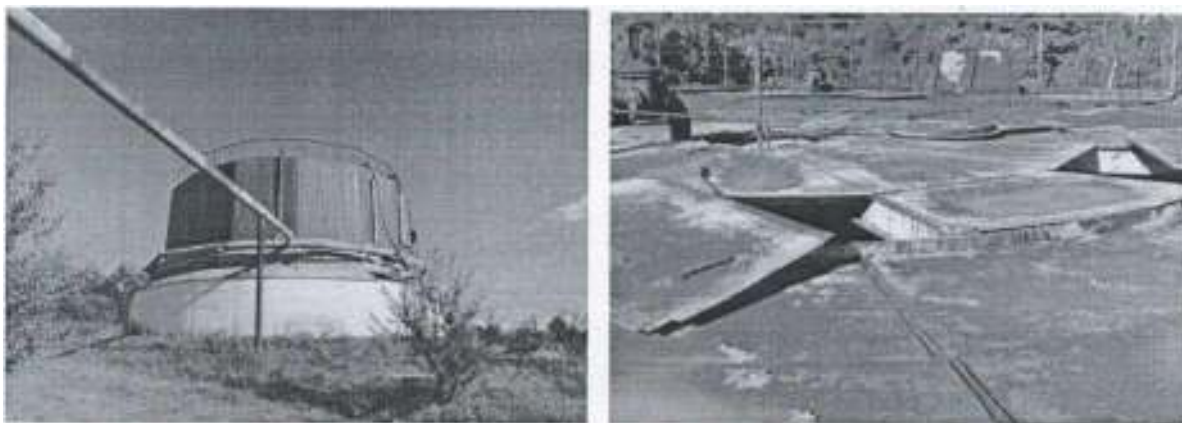
Фото незадовільного технічного стану установки «Екокомпакт-2500» Перебування людей є небезпечним, експлуатація споруди недоречна. У незадовільному стані також знаходиться і прийомний резервуар
